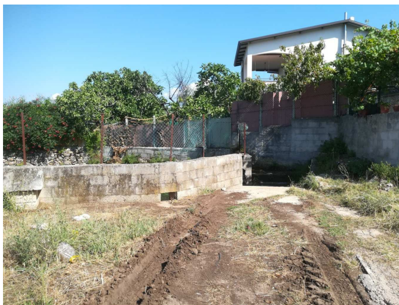
Esempio di Elementi di degrado (sorgente Ospedale)
